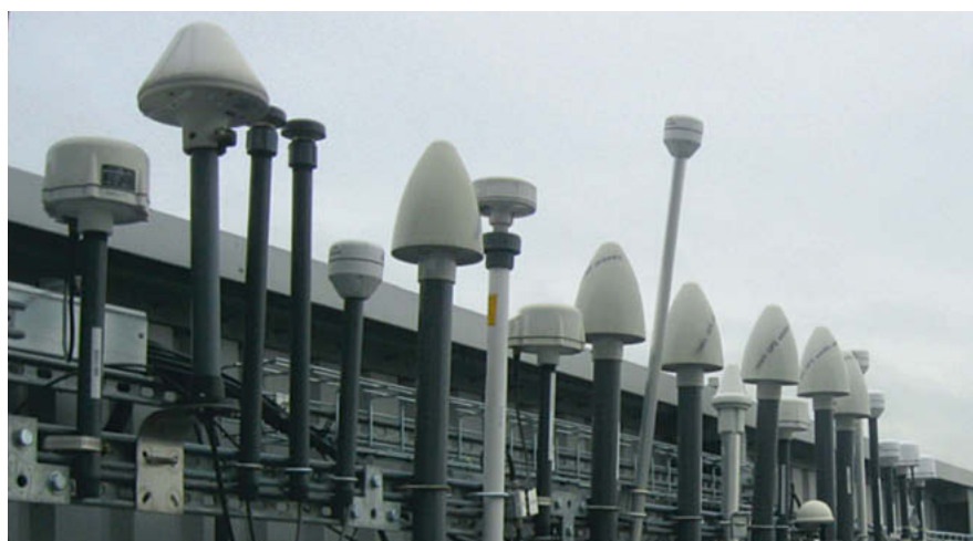
Rys. 2. Przykład wadliwej instalacji anten
